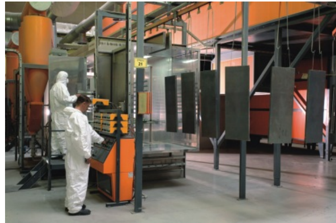
Linia malowania proszkowego
